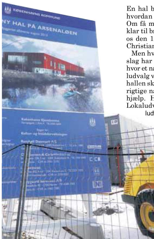
Hallen skal fremstå med samme udtryk som nogle af Holmens gamle bygninger, som f.eks Kanonbådsskurene. foto: Marie Markus
